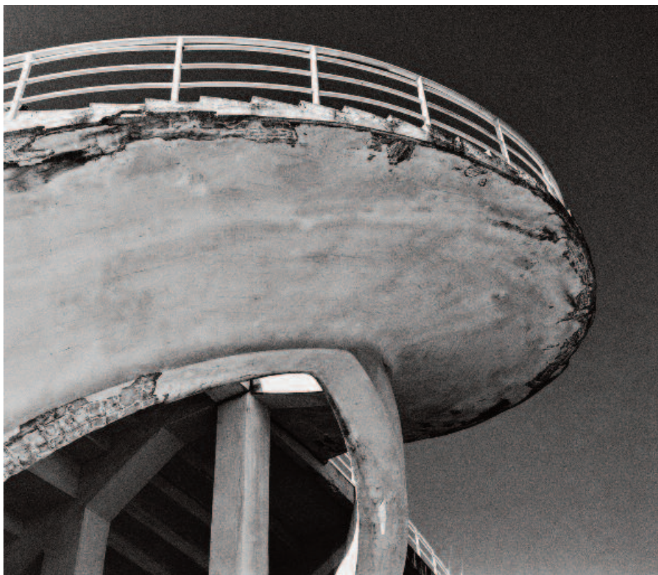
2. Il deperimento delle strutture in cemento armato dello stadio Artemio Franchi.
